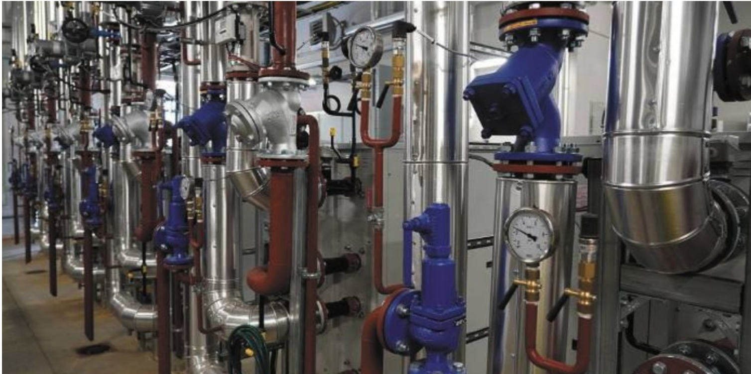
Układ odzysku ciepła ze ścieków dla wysokiego budynku (28 pięter) Wintower, Niemcy umożliwia odzyskanie ok. 600 kW mocy grzewczej (źródło: Rynek Instalacji 12/2023)
